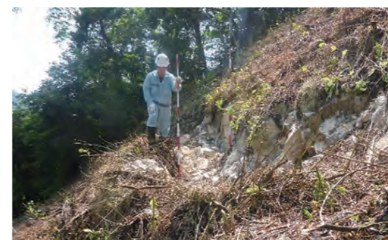
写真3. 滑落崖の状況（5段目法面）
