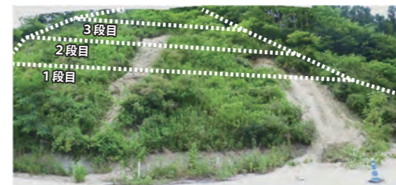
写真1. 被災箇所の地上目視状況
