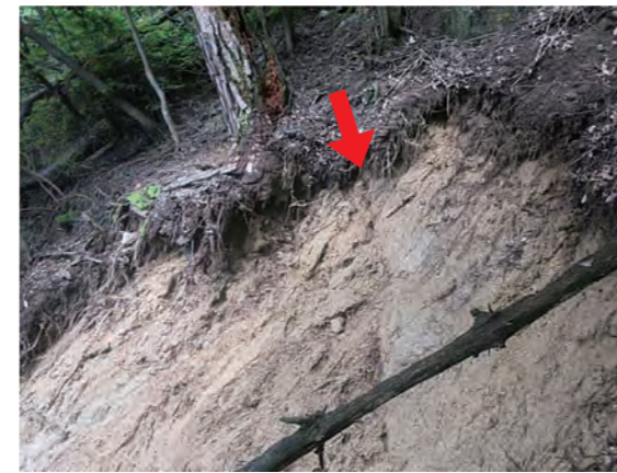
浅口市の土石流源頭部の湧水を伴う弱面
